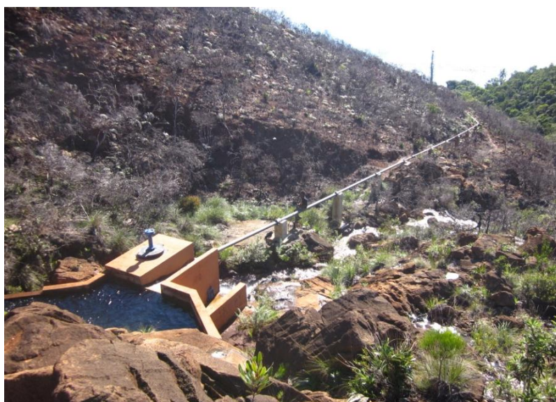
Figure 3 : Photo du captage de New Grand Borendy
