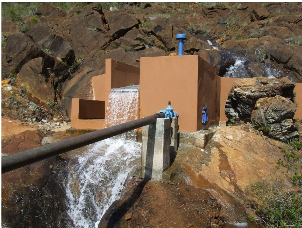
Figure 2 : Photo du captage de New Grand Borendy
