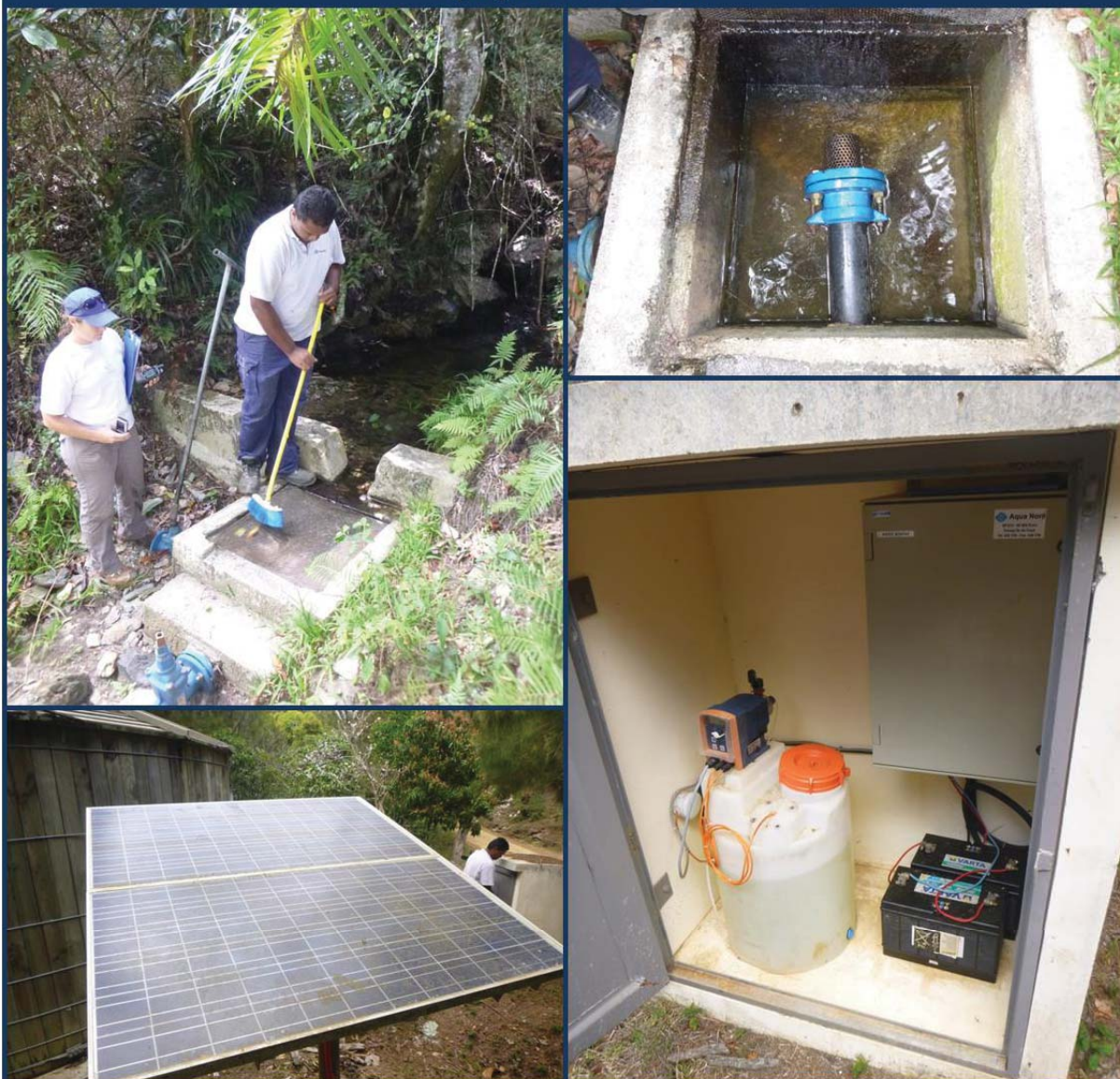
Javellisation alimentée par énergie solaire
