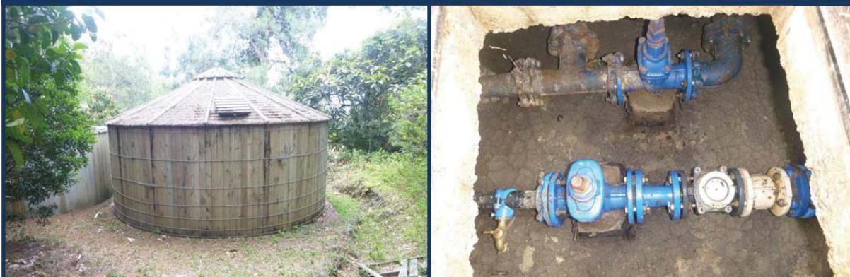
Réservoir de Petit Atéou et sa chambre des vannes
