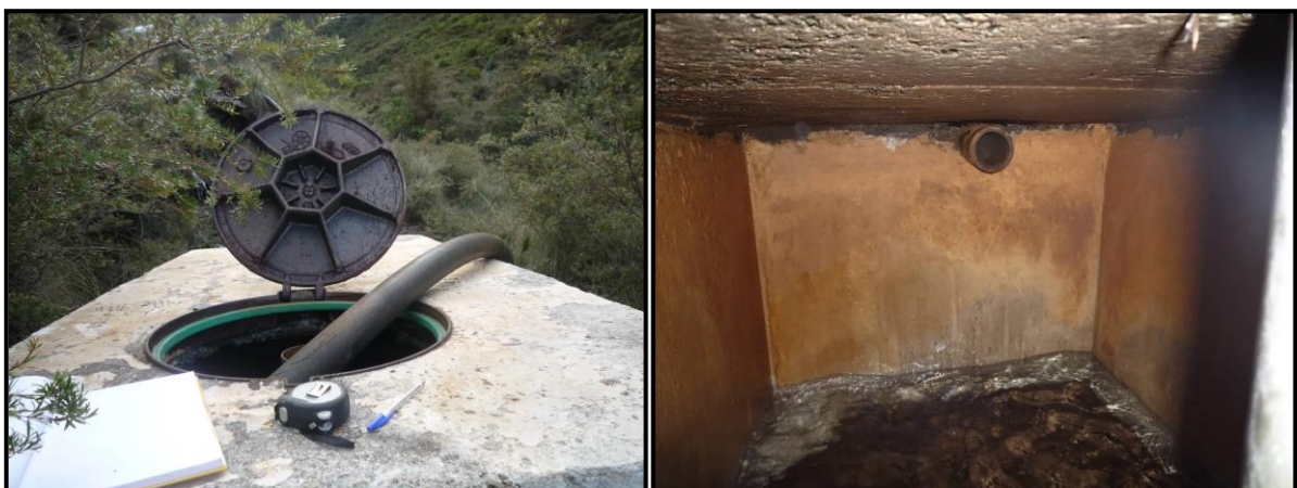
Photo 11 : Arrivée du tuyau provenant du captage de la source dans la bêche de reprise (à gauche), arrivée d'eau de la prise d'eau en rivière à l'intérieur de la bêche de reprise (à droite) – HYTEC, 15/06/09
