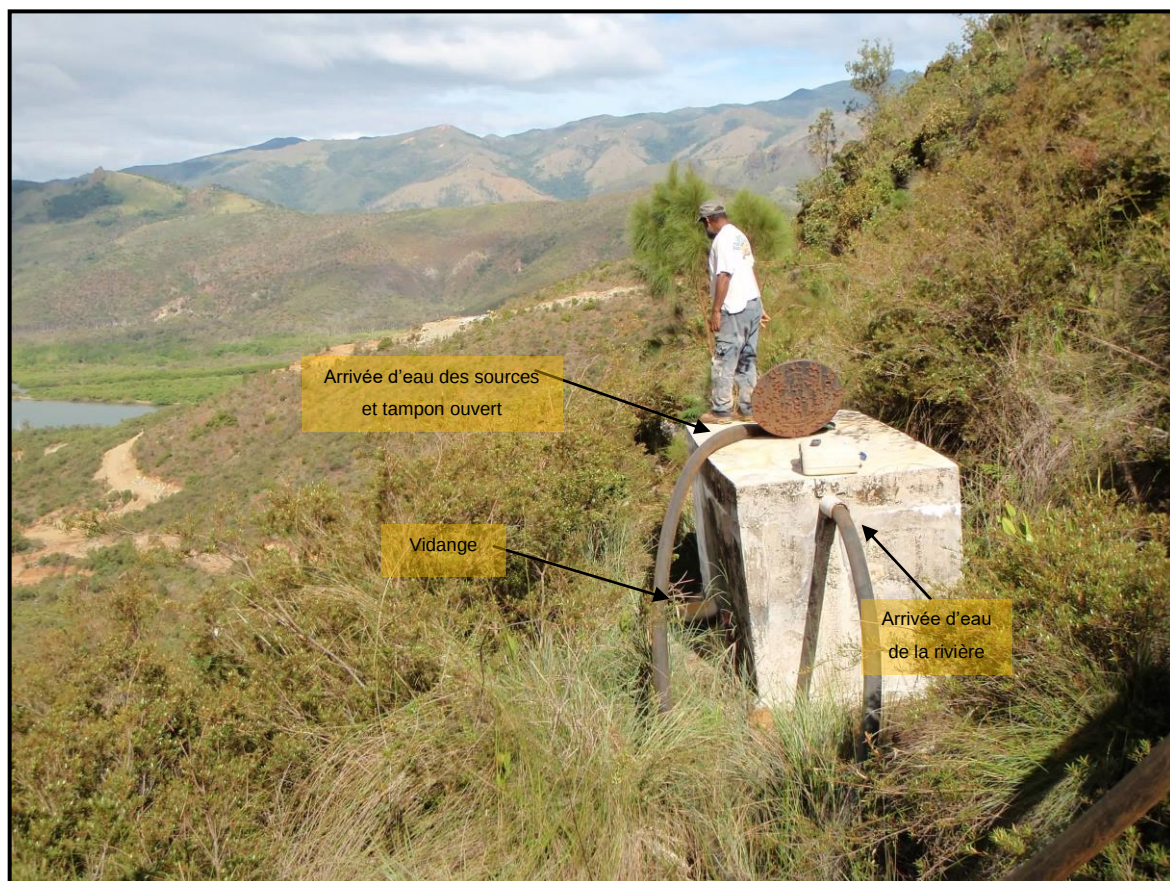
Photo 13 : Bâche de reprise vue à partir du captage de la source - HYTEC le 15/06/09
