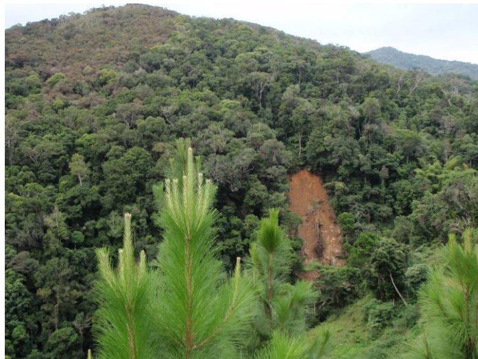
Figure 9 : Photographie d'un arrachement observé en aval du captage d'Ema
